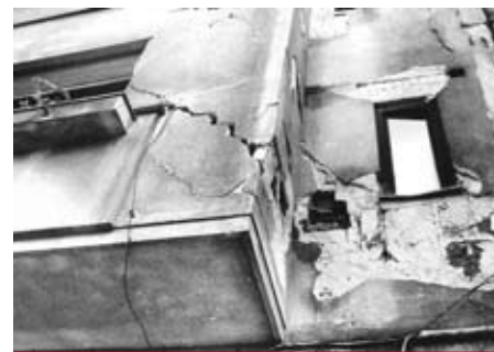
Bowindowurile, elemente arhitecturale adoptate în București, care s-au dovedit foarte vulnerabile la cutremurul din 1977 (Calea Moșilor nr. 133)
